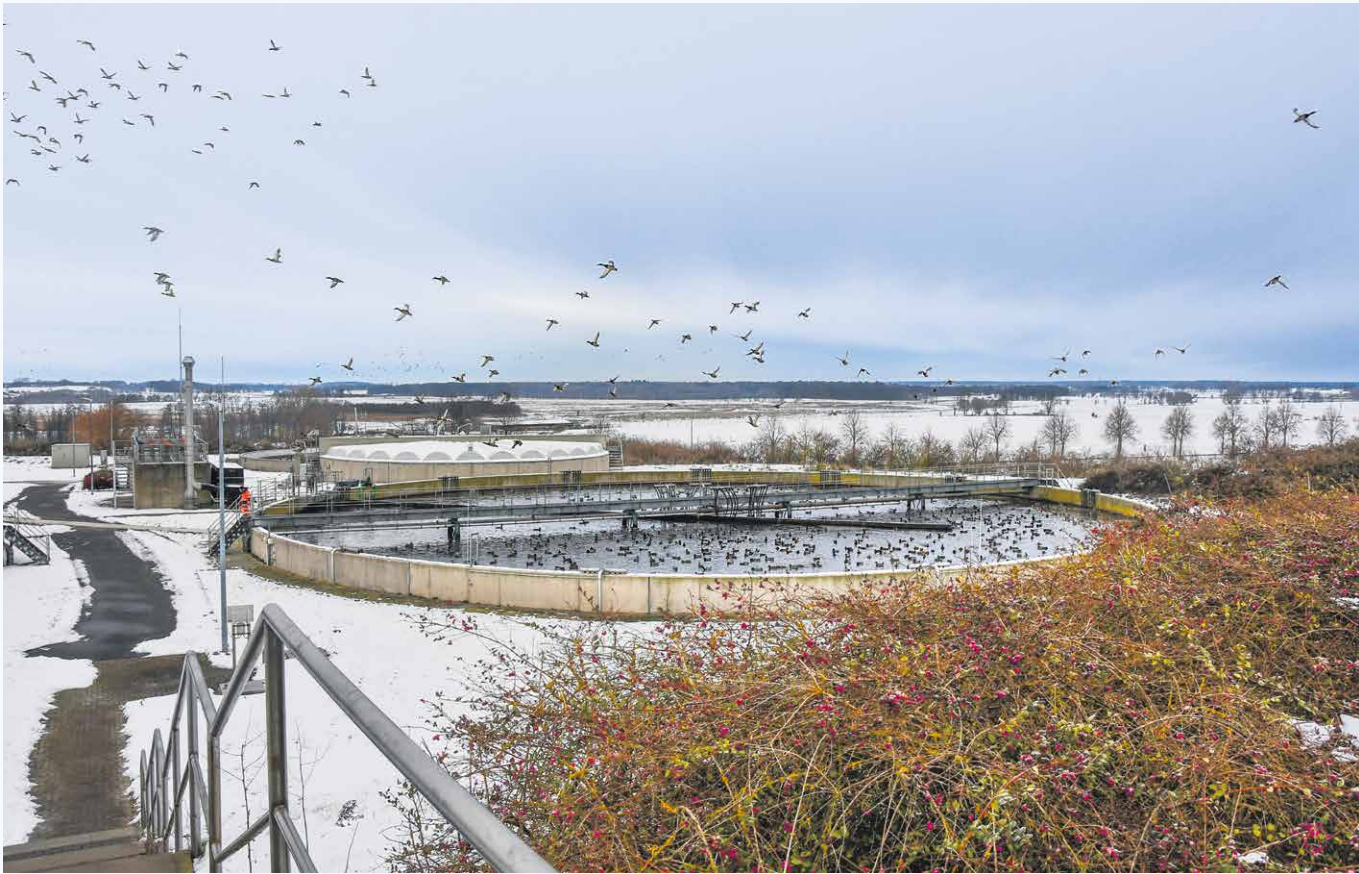
Das Wasser durchläuft die Kläranlage Wolgast etwas mehr als vier Tage, bis es gereinigt ist.
