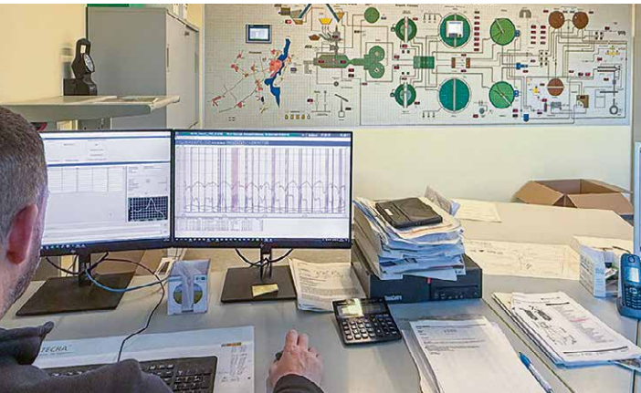
In der Schaltzentrale behalten die Klärwärter alle Anlagen und automatisierten Prozesse im Blick, um im Notfall einzugreifen.
