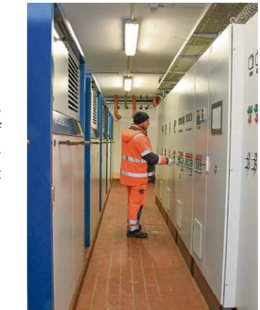
Anlagen steuern die Aggregate, die Sauerstoff ins Belebungsbecken drücken.
